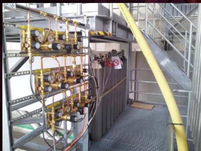
各種ガスボンベと圧力制御ユニットの設置例
