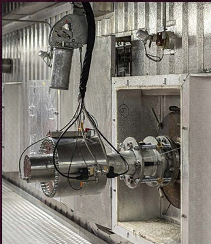
マンホールに設置した圧力波式スートブロワ
